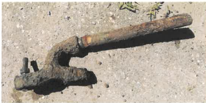
Leszerelt, elkorrodálódott csőbéklyó és bekötővezeték
