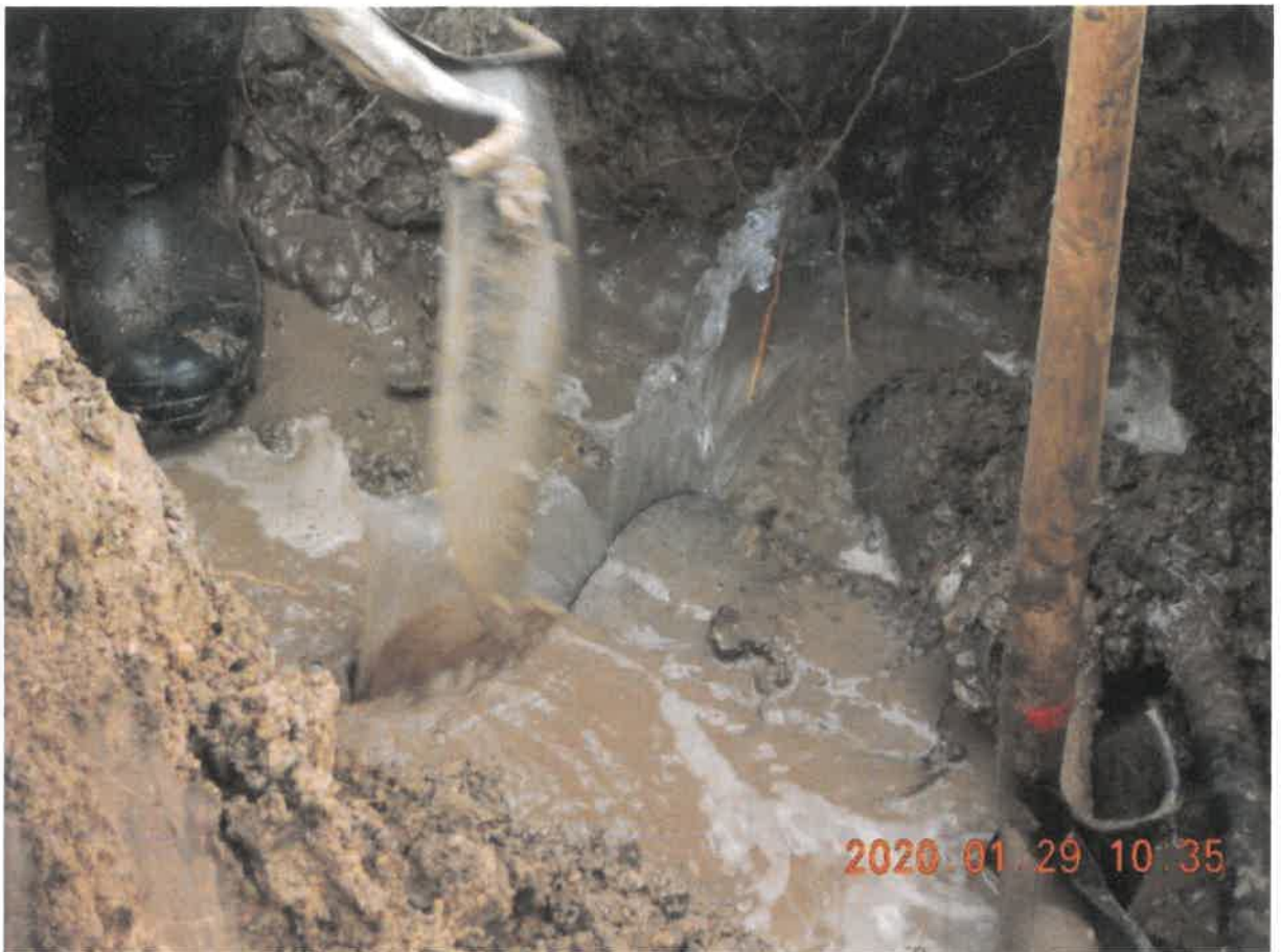
NA200-as AC csővezeték haránttörése
