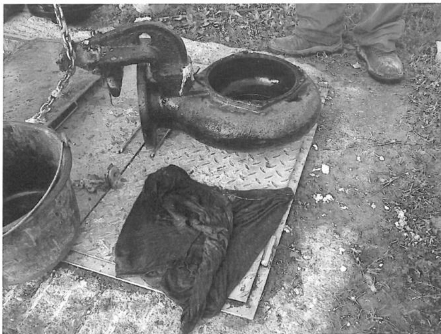
Átemelő műtárgy karbantartáskor talált ruhadarab
